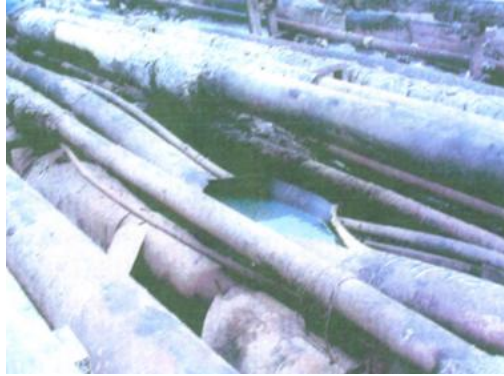
Fot. 3. Zniszczenie rurociągu T-128 wskutek wzrostu ciśnienia wewnątrz rurociągu /paliwo lekkie/
