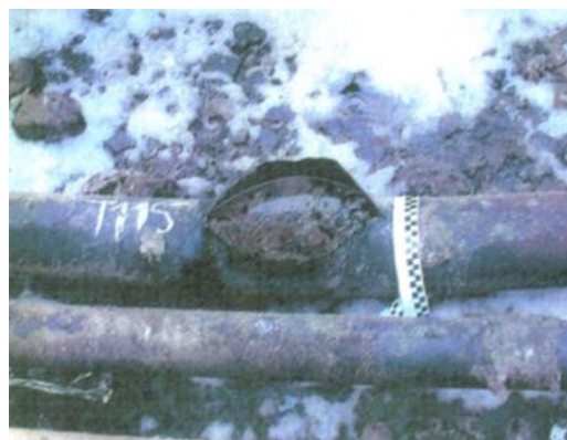
Fot. 2. Zniszczenie rurociągu T-115 wskutek wzrostu ciśnienia rurociągu /benzyna/
