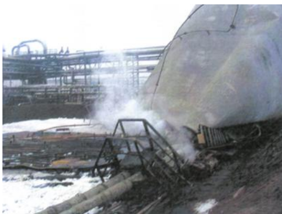
Fot. 5. Deformacje zbiornika ZM3 wraz z widocznym oderwaniem od fundamentu wskutek wybuchów
