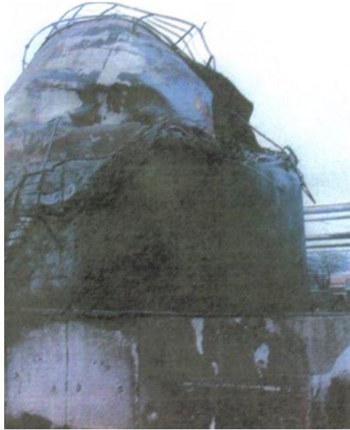
Fot. 7. Deformacje zbiornika ZM1
