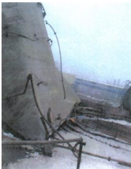
Fot. 4. Deformacje zbiornika ZM3 po awarii z jego widocznym przemieszczeniem.
