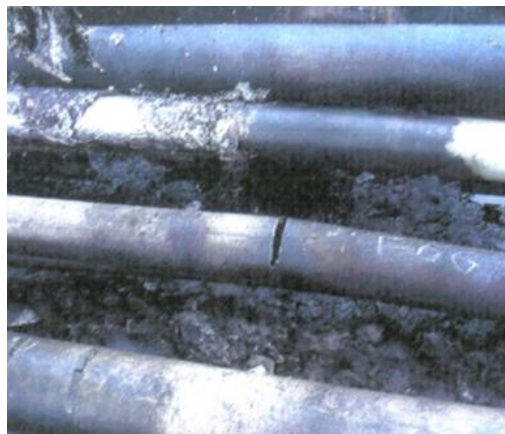
Fot. 1. Pęknięcie rurociągu T-66 – głównej magistrali sropowej zakładu – wyciekające z pękniętego rurociągu sropy, gromadzą się w muldzie, tworzyły rozlewisko na dnie muldy i w wyniku odparowania chmurę
