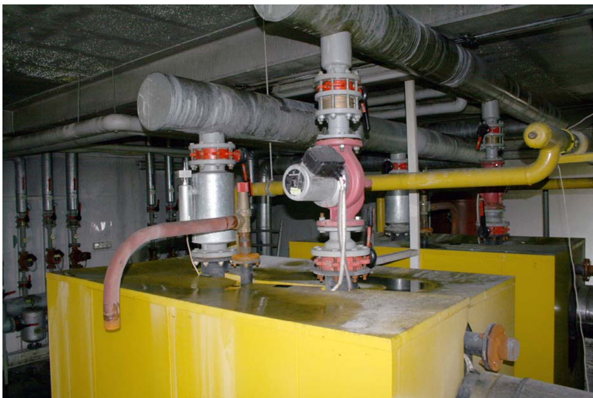
Widok wydzielonej kotłowni gazowej. Brak śladów oddziaływania środowiska pożaru 14
