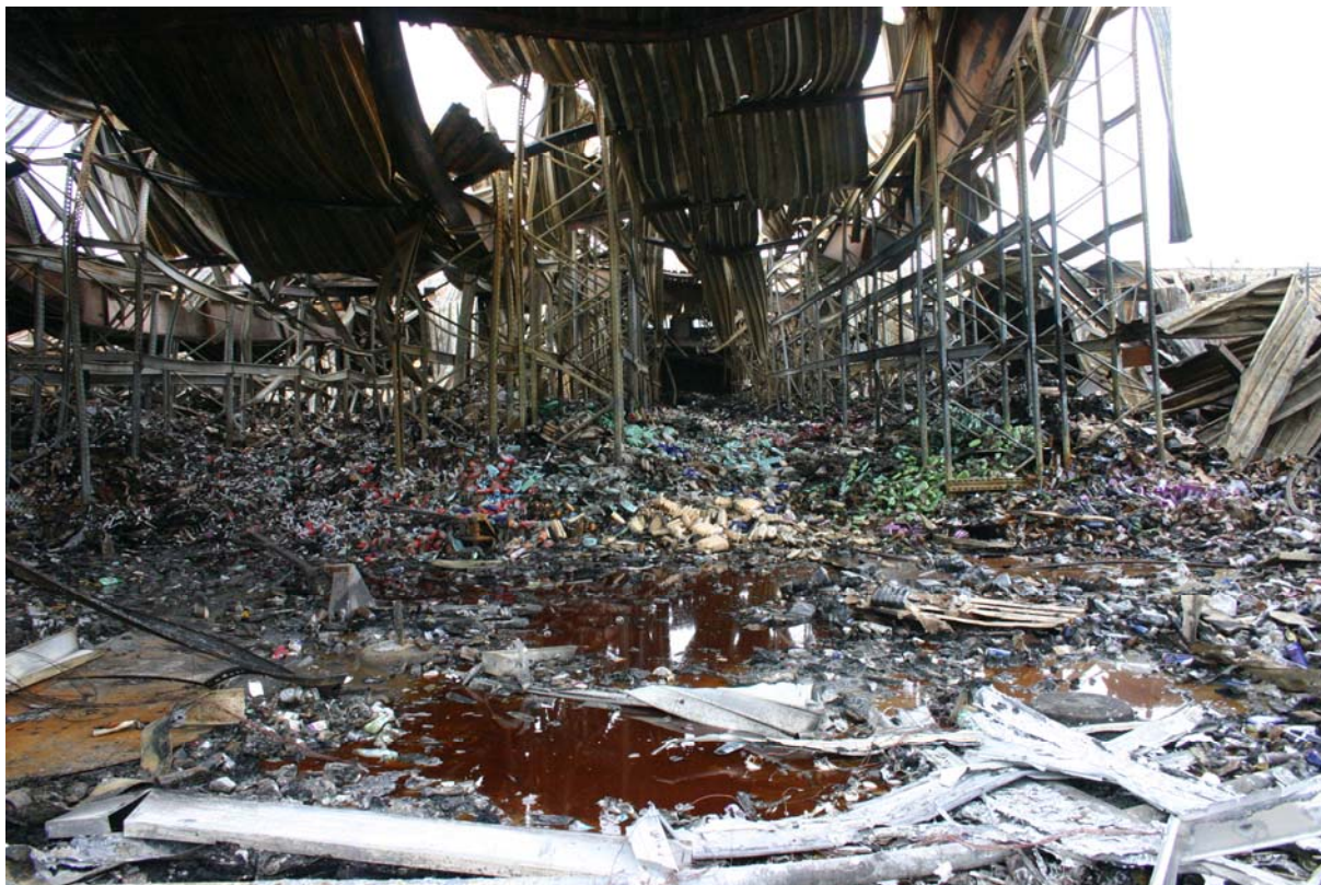
Widok pogorzelniska oraz regalów wysokiego składowania 9
