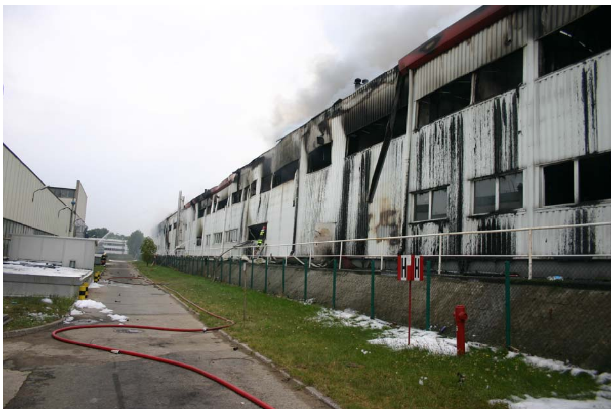
Widok zniszczonego budynku od strony zachodniej 3
