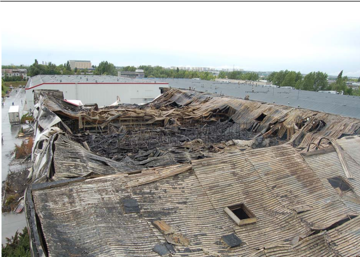
Widok zniszczonego budynku 5
