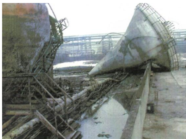
Fot. 6. Deformacje zbiornika ZM2; oderwanie od fundamentu wraz z widocznym przemieszczenie zbiornika poza betonowy murek
