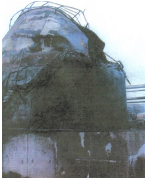
Fot. 7. Deformacje zbiornika ZM1
